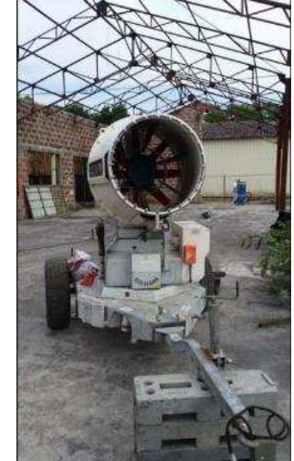
Canon de brumisation « amiante » bâtiment sinistré
