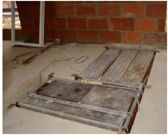
Trémie positionnée contre un mur. Absence d'escalier. Photo Altrad
